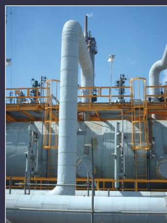
Трубопроводы для аммиака
